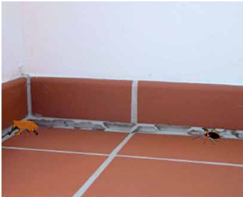
Beispiel einer Randabsenkung bei konventionellem Zementestrich
